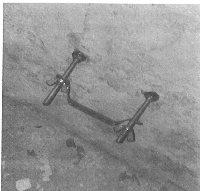
INSTALLAZIONE NON TERMINATA
